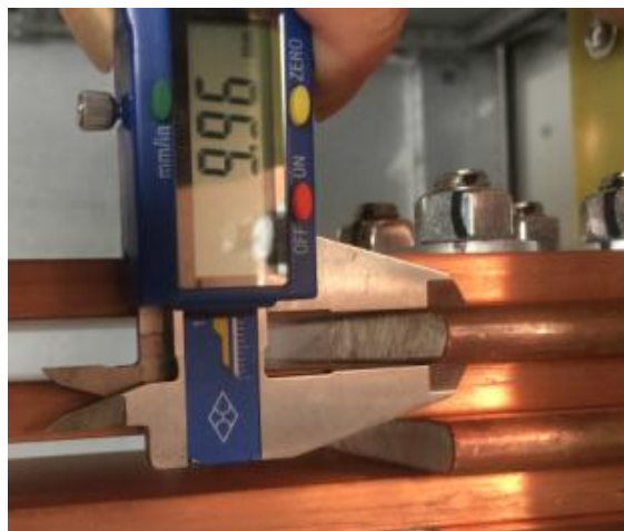
主开关及进线宽度、厚度
